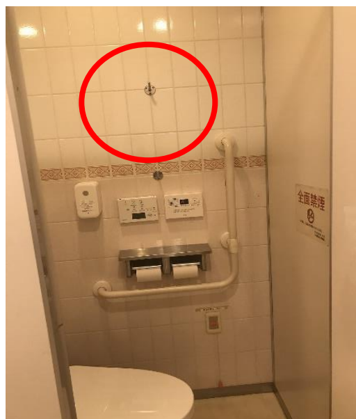
地下1階トイレ
